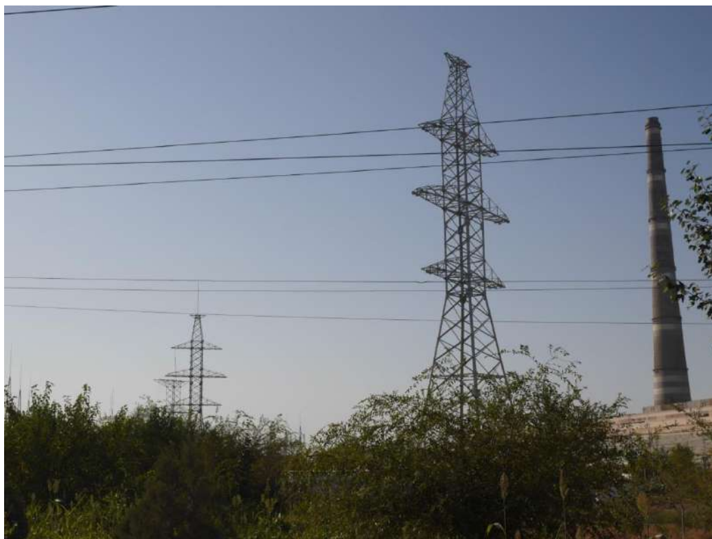
Рисунок 4.3.3. - Опоры ЛЭП на участке примыкания к Сырдарьинской ТЭС
